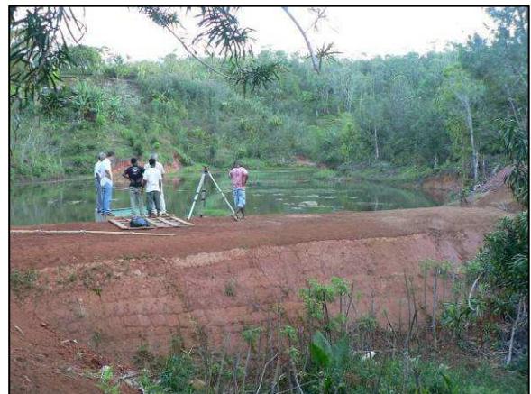
Photo 6: Appui conseil des techniciens de l'APDRA-F et suivi de l'aménagement de Madagreen avec une lunette topographique.
